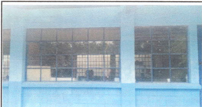
Foto 7: Aula numero 2 Sustrucción de estructura de metal de ventana por PVC y balcones de metal, Modulo 2
